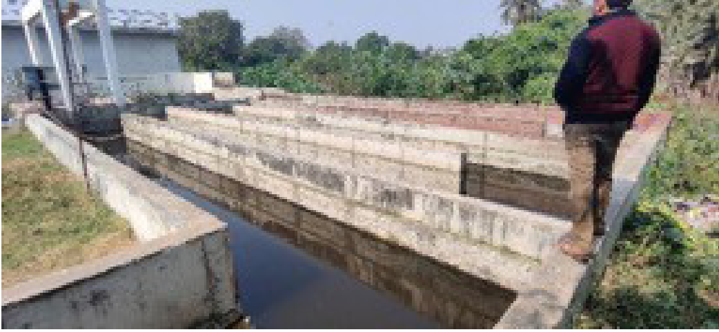
तस्वीर 17: 26 एमएलडी क्षमता का इन्टर्सेप्शन एवं डायवर्जन आधारित एसटीपी
